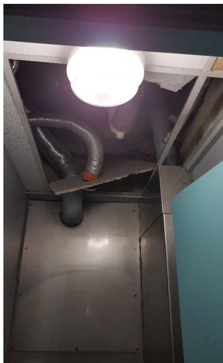
Plafond WC vers bureau Chef de 1/4 (Comme ça depuis au moins 2 ans seulement)
