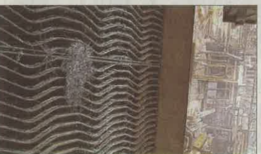
Les employés ont analysé des morceaux de fibres qui tombent du toit. Photo ISL/CGT Verallia
